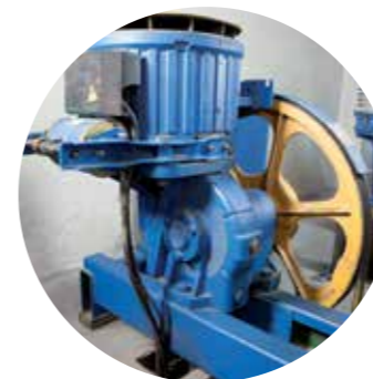
Brusquedad en los arranques y paradas del ascensor
